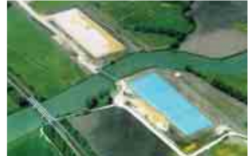
Consolidation par Vacuum™ des remblais d'accès (10 m) de l'ouvrage de franchissement de la Boutonne. Autoroute A837, secteur de Saintes-Rochefort (France).
