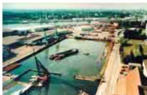
Consolidation par Vacuum™ de boues de dragage du port de Lubeck (Allemagne) : remblaiement de la darse.
