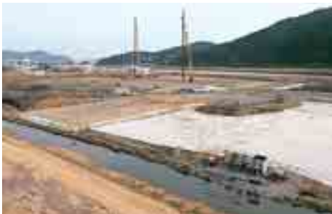
Mise en oeuvre du Vacuum™ pour consolider 40 m d'argiles molles en vue de fonder la station d'épuration de Pusan (Corée). Vue de la membrane installée, chantier en cours de pompage.
